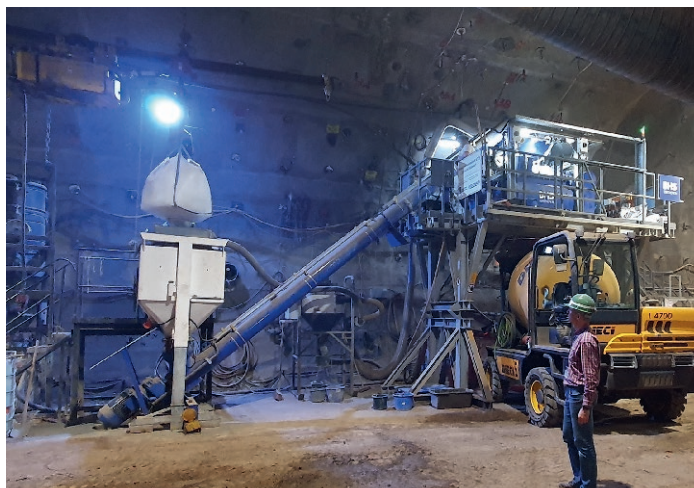
Fig. 3. The BHS twin-shaft batch mixer of type DKX 0.75 in operation underground at the Konrad mine in Salzgitter-Bleckenstedt. Bild 3. Der BHS Doppelwellen-Chargenmischer vom Typ DKX 0,75 im Einsatz unter Tage in der Schachtanlage Konrad in Salzgitter-Bleckenstedt. Photo/Foto: BGE
